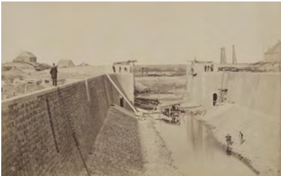
Afb. 5. Bouw van de schutsluis te Wemeldinge gezien uit het zuiden. Foto door Pieter Oosterhuis (1816-1885) op 2 oktober 1865. Zeeuws Archief, Zeeuws Genootschap, Zelandia Illustrata, deel III, nr 324-34.
