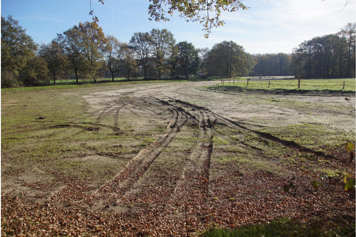
(werkzaamheden in het terrein om ruimte te maken voor water, afb. ve).
