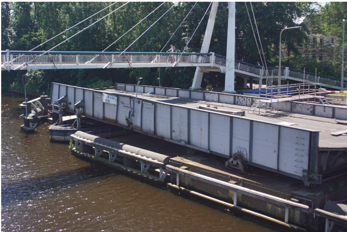
(afbeelding VE, de beschadigde Gerrit Krolbrug)
