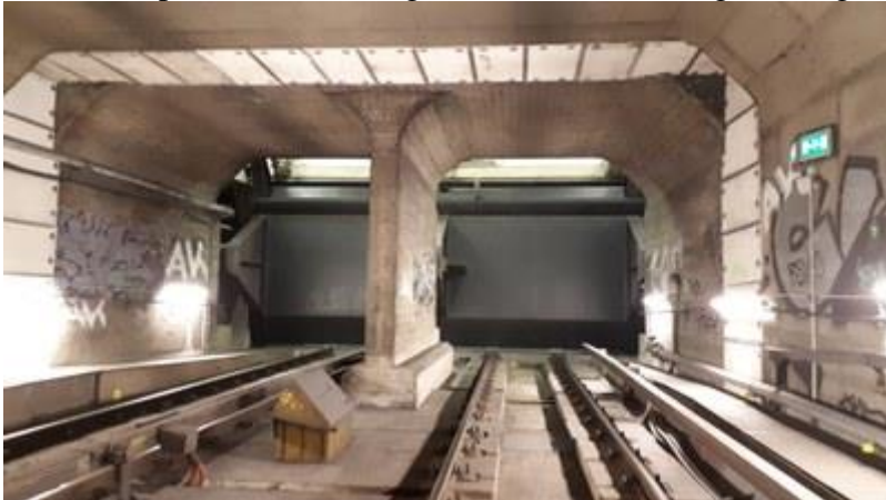
Afbeelding van de noodschuiven in de tunnelbuis (Hoogheemraadschap van Schieland en de Krimpenerwaard)
